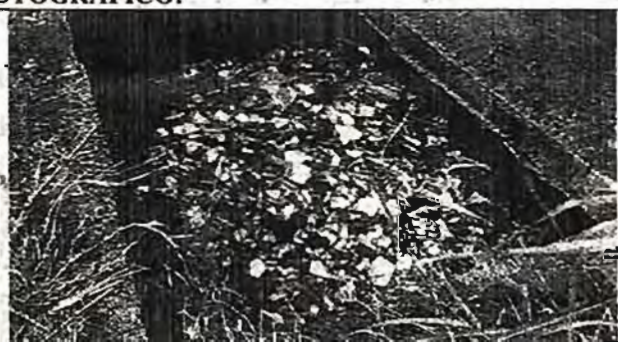
Foto 02 - Acúmulo de resíduos sólidos na entrada da bacia.
